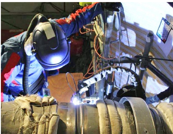
Mise en œuvre du procédé TIG orbital – soudure sur le circuit secondaire principal
